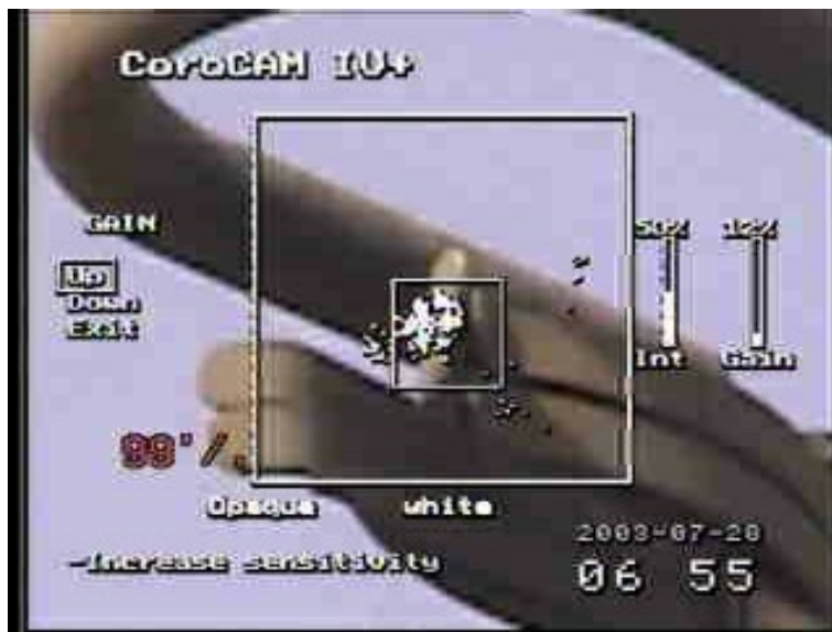
شکل ( ۳۴ ) - کرونای موجود بر روی تیغه سکسیونر در پست ۲۳۰ کیلوولت بعث ( شرکت برق منطقه ای تهران )
