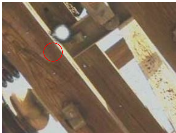
شکل (۳۱) - آشکارسازی ضعف موجود بر روی اتصال زمین یک پست فشارقوی توسط دوربین کرونا
