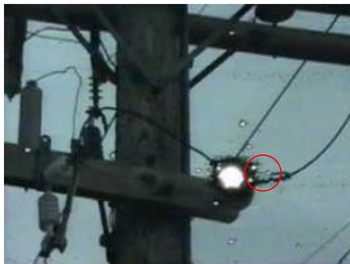
شکل ( ۳۵ ) - تصویر کرونای ناشی از یک مقره چینی شکسته در روی خط ۲۰ کیلوولت
