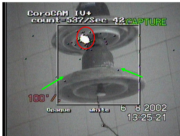
شکل (۶) - آشکار نمودن خرابی در محل اتصال دو بشقاب مقره و مشخص شدن ترکهای موئی روی سطح مقره سرامیکی
