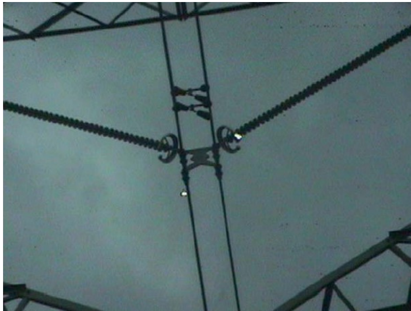
شکل (۹) – علیرغم نصب رینگ یکنواخت کننده میدان ، طراحی و یا نصب رینگ نامناسب می باشد.
