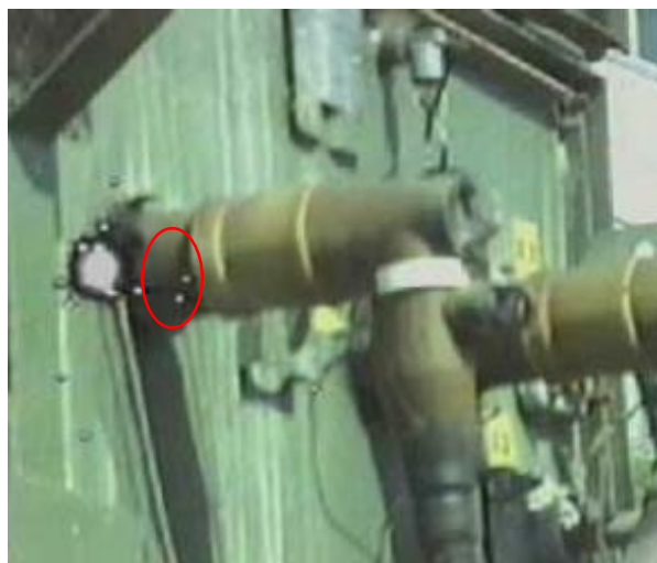
شکل (۳۸) - تصویر کرونای ناشی از زانوئی (Elbow) یک ترانس توزیع (سمت فشار قوی)
