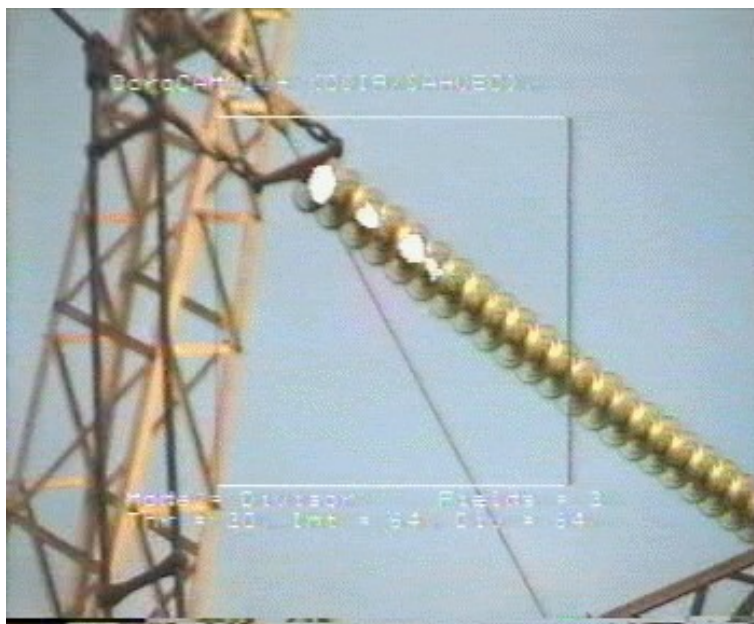
شکل (۱۱) - کثیف بودن چند مقره از خط انتقال
