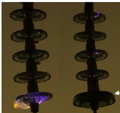
شکل (۱۴) - کرونای مقره انتهائی ناشی از رطوبت و آلودگی که بعد از تعویض آن پدیده کرونا برطرف شده است.
