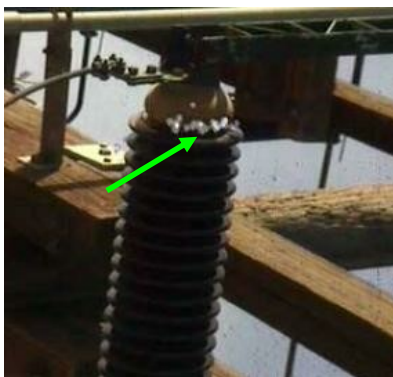
شکل (۳۰) - کرونای ناشی از عیب موجود بر روی مقره اتکائی
