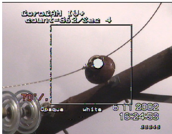
شکل (۳۶) – کرومای ناشی از ترک موجود بر روی یک مقره شبکه هوایی توزیع نیروی برق
